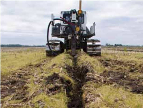
農地にタイル(暗渠)を埋設する作業:画面向かって左に見える黒い管がタイルと呼ばれる排水管で、農地の地下に埋設して排水する
