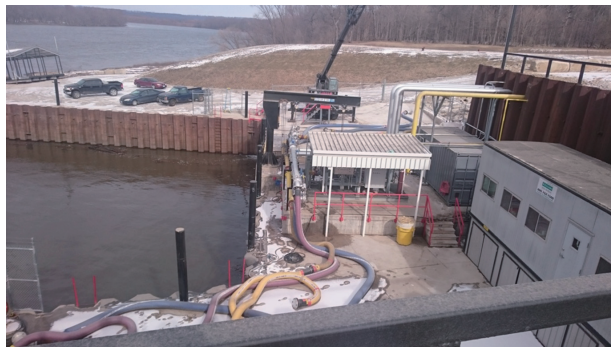
図14 マルキース・エネルギー社ヘネピン工場のエタノール出荷施設
