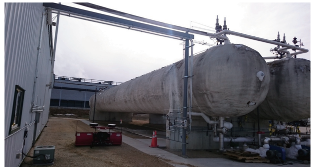
左側の工場から右側のシリンダー状タンクに炭酸ガスが送られる
