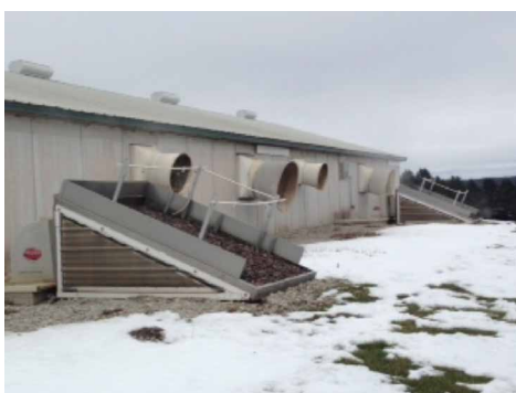
写真25 豚舎に設置されているバイオフィルター
